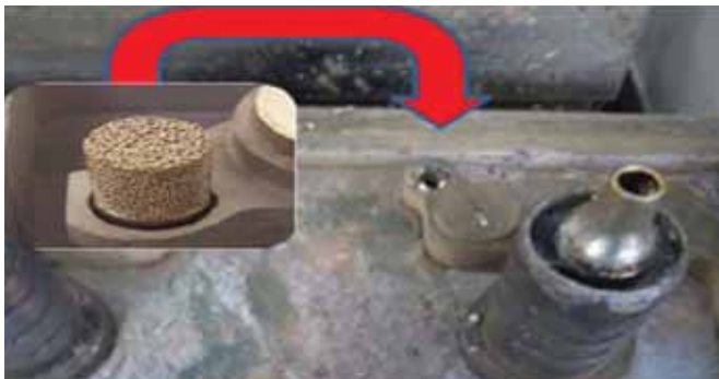
Рис. 21 Повреждение колпачка распыления азота в установке А
